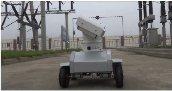
图4 变电站巡检机器人
